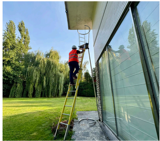
Trabaja EN DESNIVEL con total seguridad
